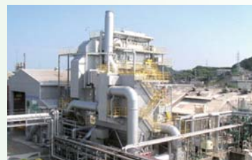
バイオマスボイラー全景
