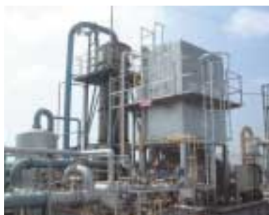
排気燃焼設備
