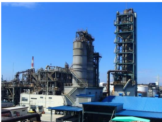
BPAプラント（三井化学 大阪工場）
