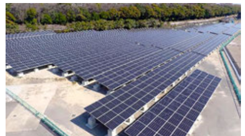
名古屋工場に設置された太陽光発電設備
