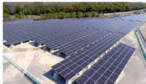
名古屋工場に設置された太陽光発電設備
