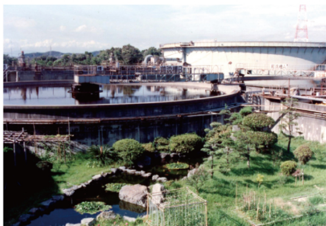
1975 (昭和50) 年に横須工場に設置した総合排水処理設備
