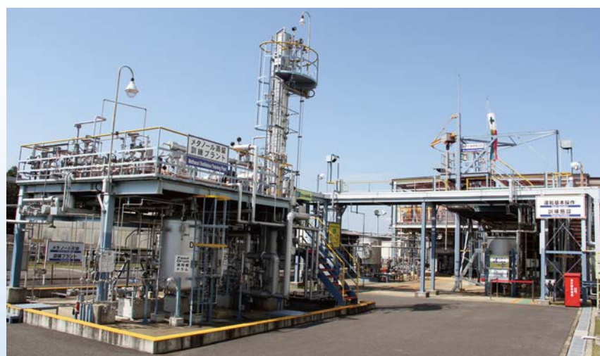
メタノール蒸留訓練プラントと水運転設備
