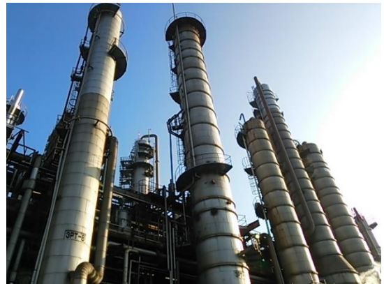
フェノールプラント
