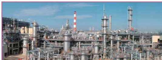
市原工場のEPT増強プラント
