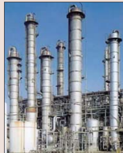
大阪工場フェノールプラント
