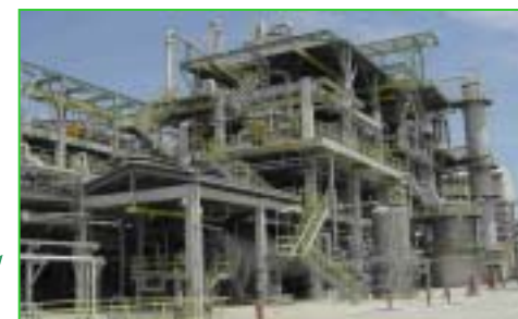
PTA +10万t/y 90万t/y 完工・営業運転04年2月
