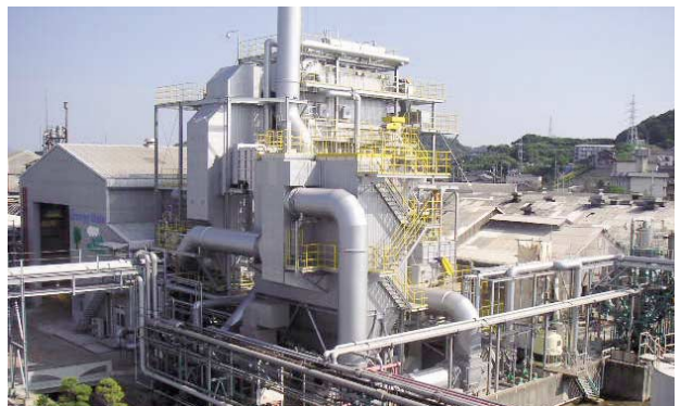
下関三井化学(株)のバイオマスボイラー
