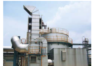
市原工場に設置した蓄熱燃焼装置
