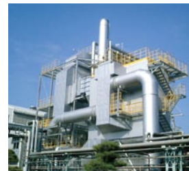
下関三井化学のバイオマスボイラー
