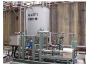
大阪工場の汚泥可溶化装置
