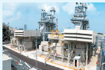
市原工場の 自家発電タービン装置
