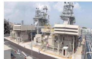
市原工場の自家発電タービン装置
