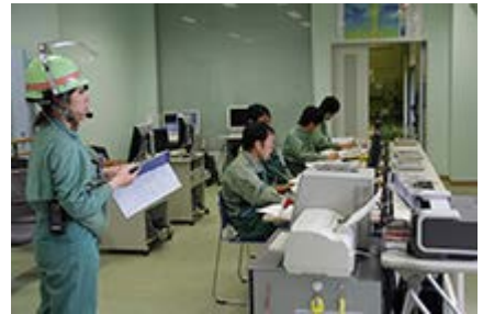
蒸留塔計器室
