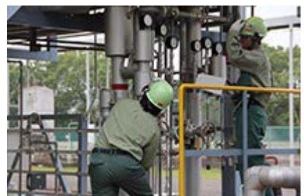
蒸留塔 用役活かし作業
