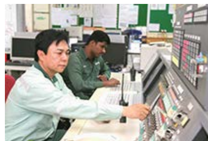
コントロール・ルームでの作業風景
