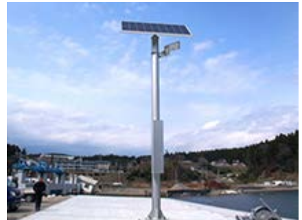
南三陸の漁港に設置されたソーラー街灯
