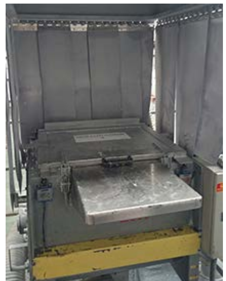
原材料投入口の局所排気装置の効率を改善するため、周囲にプラスチック製のカーテンを設置
