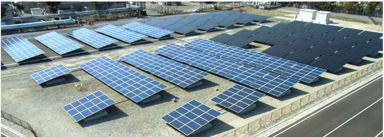
茂原実証発電所
