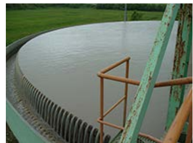
アコフロック®を使用している浄水場の様子
