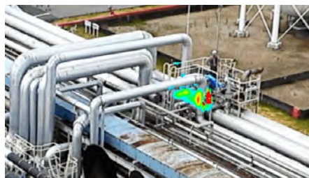
高性能カメラによるガス漏えい検知
