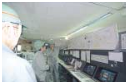
計器室でプラントの稼動状況などをチェック
