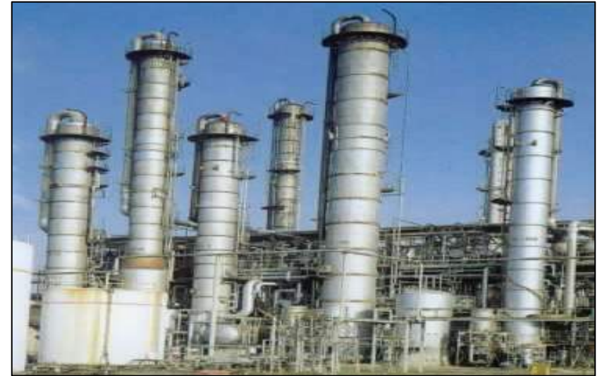
フェノールプラント(大阪工場)
