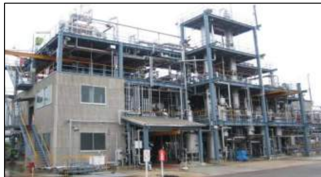
岩国/多目的セミコマーシャルプラント
